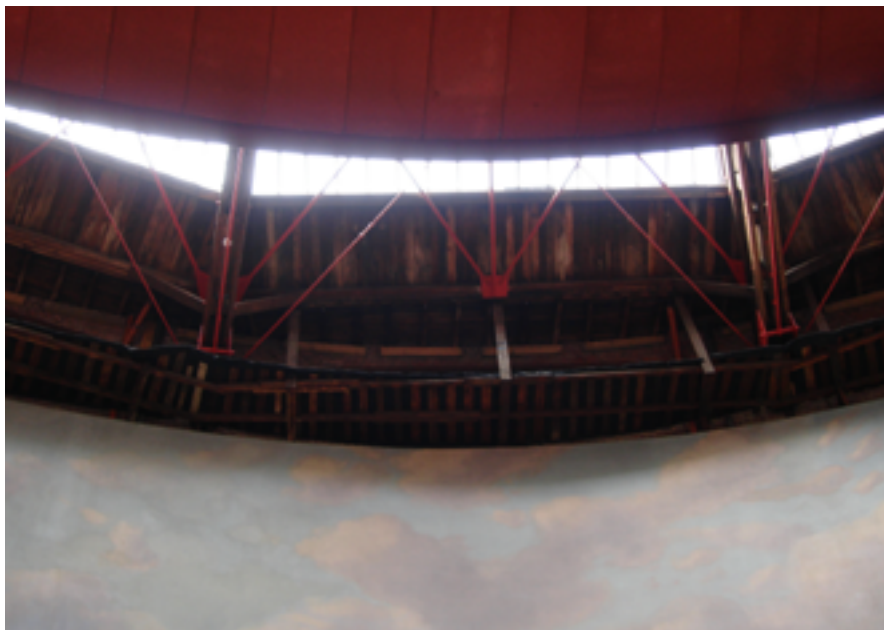
The roof top, between the velum's border and the top of the canvas. Die Dachspitze, zwischen dem Rand des Velums und der Oberseite der Leinwand.
